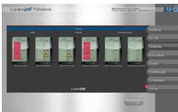
Füllstände und Tanks
